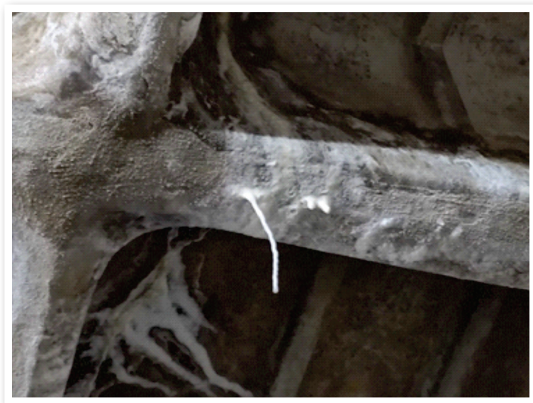
Figura 04 – Formação de estalactites pelo processo de lixiviação na estrutura de uma laje nervurada.
