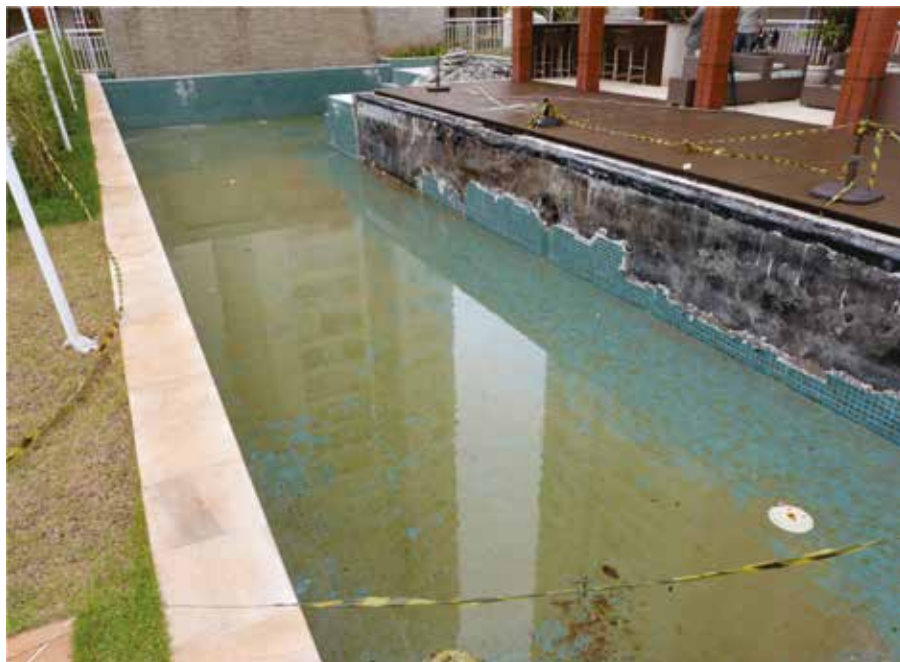
Figura 50 - Descolamento parcial do revestimento interno (outro ângulo)
