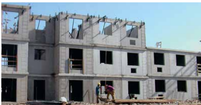
Figura 15 • Edificação em parede de concreto autoadensável sendo executada Fonte: Acervo de Bernardo Tutikian
